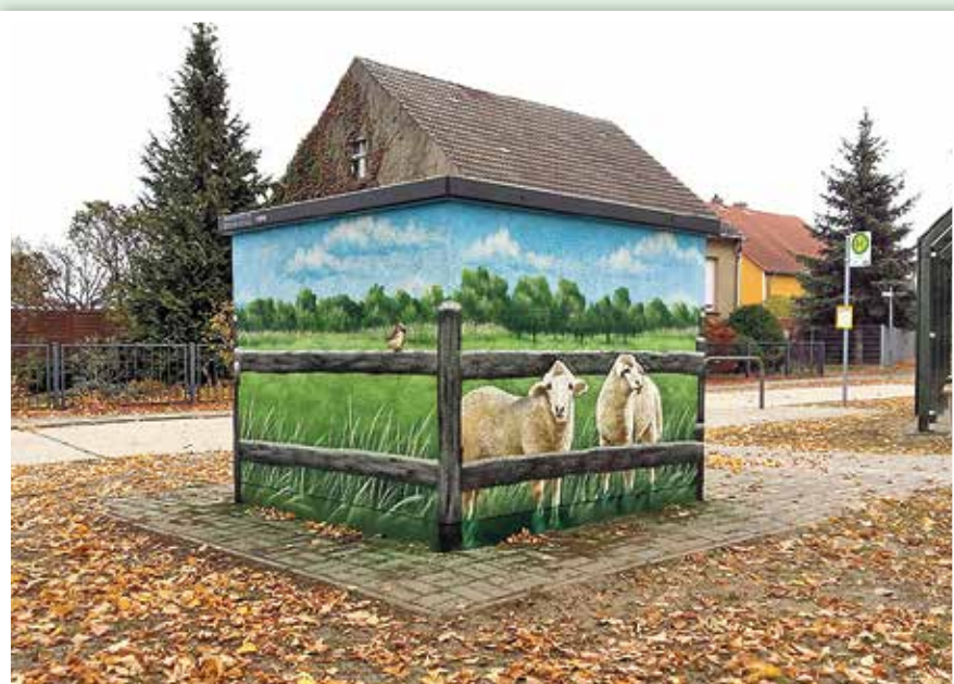
Das Trafohäuschen in Schöneweide.
